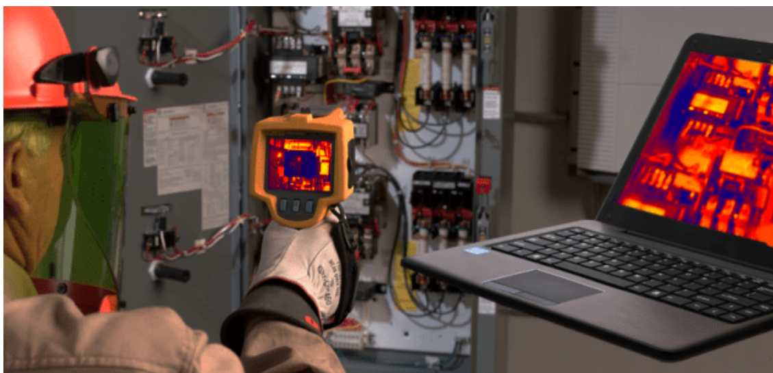
Рисунок 20. Пример проведения тепловизионного контроля электрошкафа
